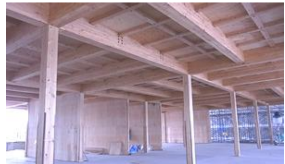
中断面集成材と住宅梁受金物による 6mグリッド2階床組+高倍率耐力壁
